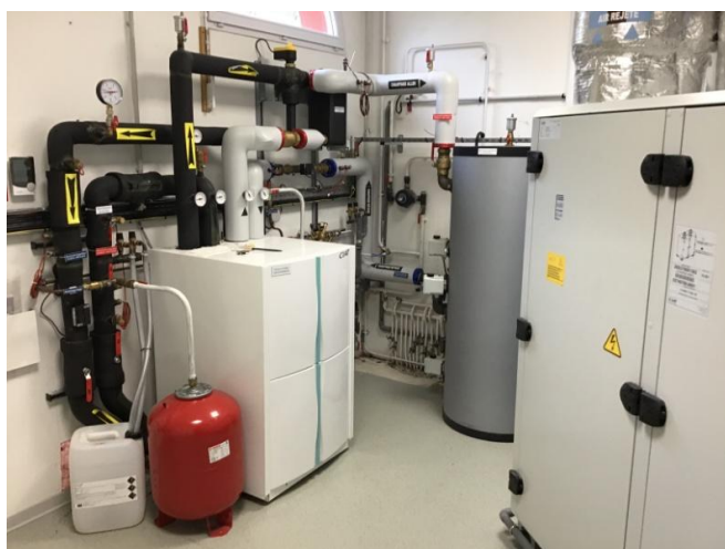
Le local technique de la chaufferie
