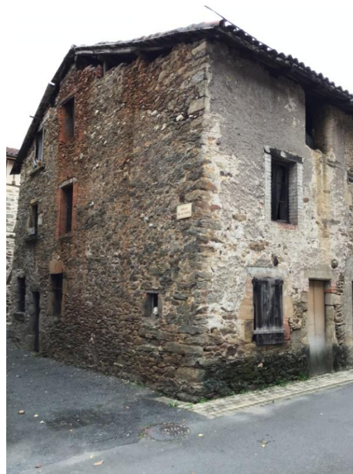
Maisons insalubres au 19 rue de La Fontaine
